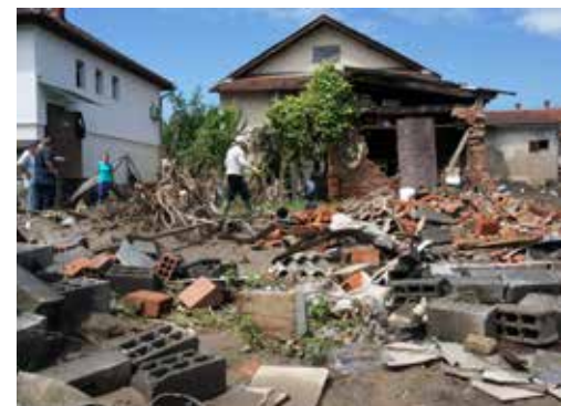
Drobné stavby jsou zvláště náchylné k poškození. Při jejich ohledání postupujte s největší opatrností, k jejich zřícení mnohdy stačí otevřít dveře.
