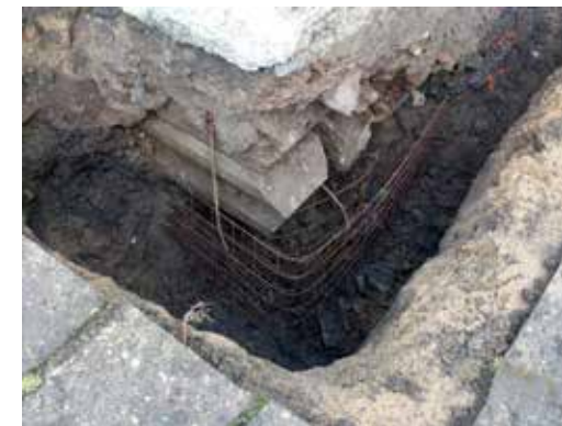
Porušené základy podbetonujte.
