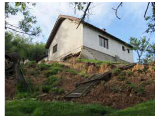
Přivalové srážky mohou způsobit podemletí základů.
