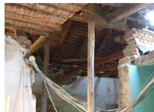
Narušené konstrukce zajistěte alespoň provizorně proti dalšímu poškození.
