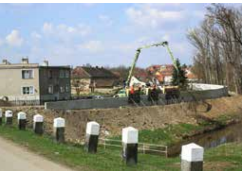
Ochranné hráze a zdi jsou finančně náročné liniové stavby, které se používají většinou při ochraně měst. Výstavba hráze v Hoříně.
