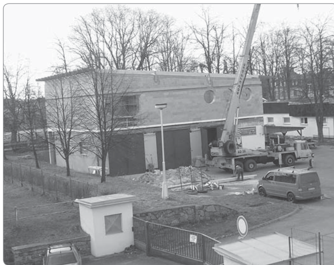
5. A tenčí den kolem šesté večer je krov s přesahy na obě protilehlé strany stavby již položen.
