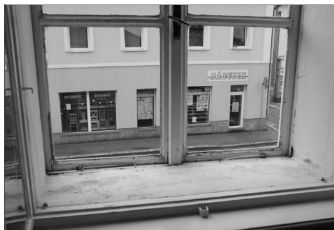
Foto: archiv MěÚ Stav oken před výměnou ZUŠ Správa majetku města
